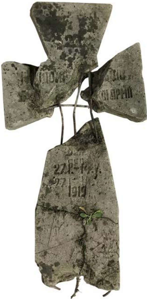
Іл. 4. Залізобетонний хрест. Об'єкт реставрації. Стан до проведення реставраційних робіт. Значні механічні пошкодження. Великі втрачені об'єми. Пил, глина, біоорганізми та інші забруднення. 2018. [Світлина автора]
