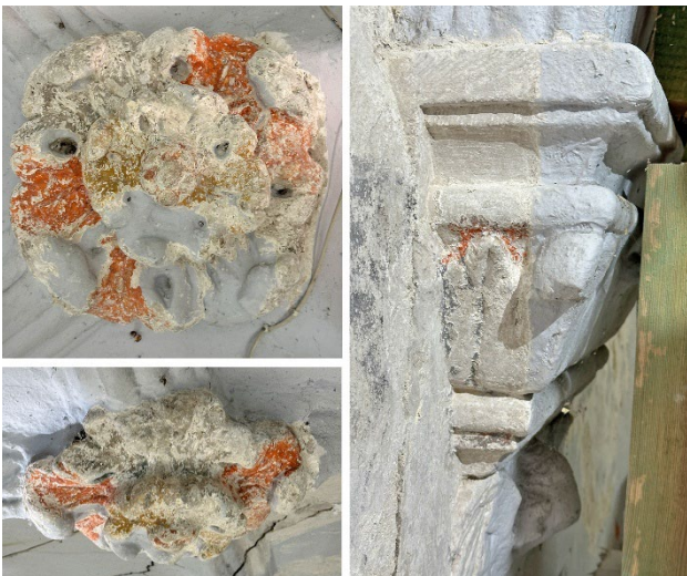
Іл. 11. Фрагменти поліхромного об'ємного оздоблення галереї на першому поверсі: перший історичний шар XVII ст. [Світлина М. Каплінської]
